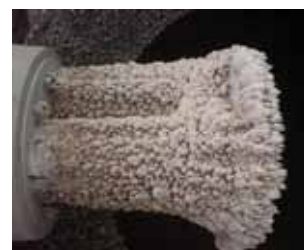
L'unità esterna è rivestita di accumuli di polvere.
